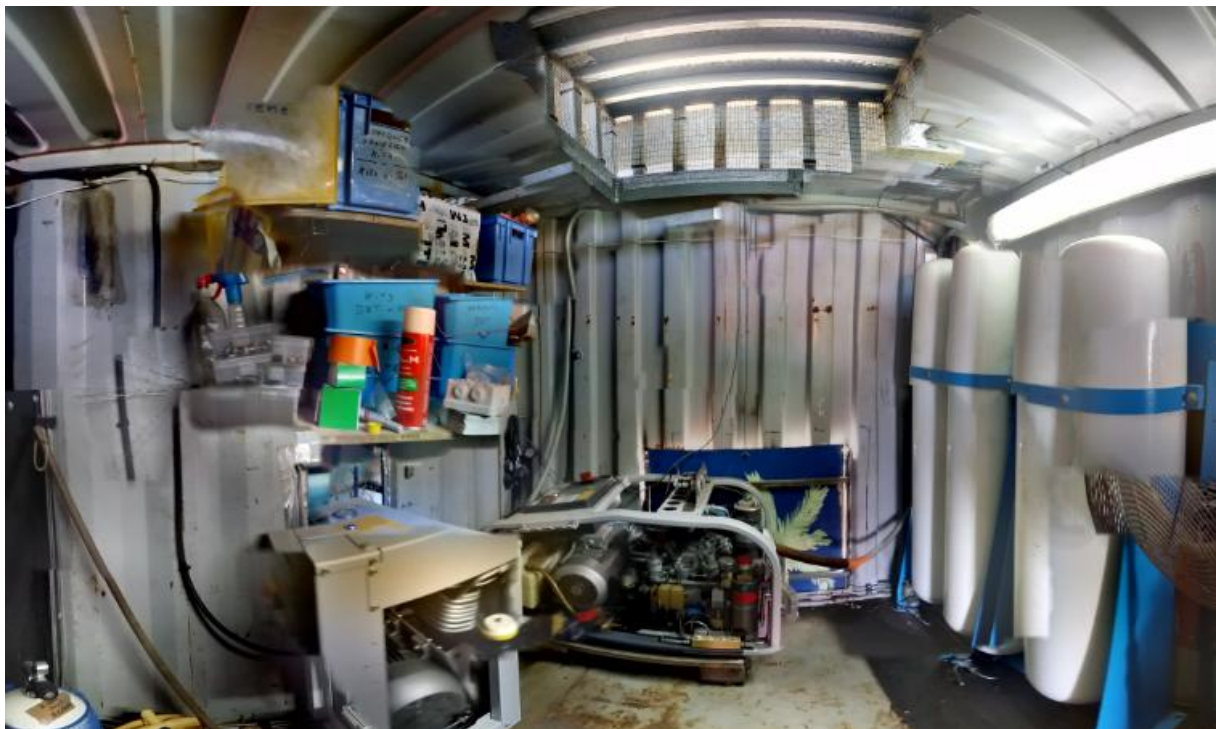
Figure 10 Partie protégée du compresseur
